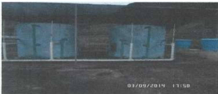
Visita planta antigua de tratamiento de agua.
