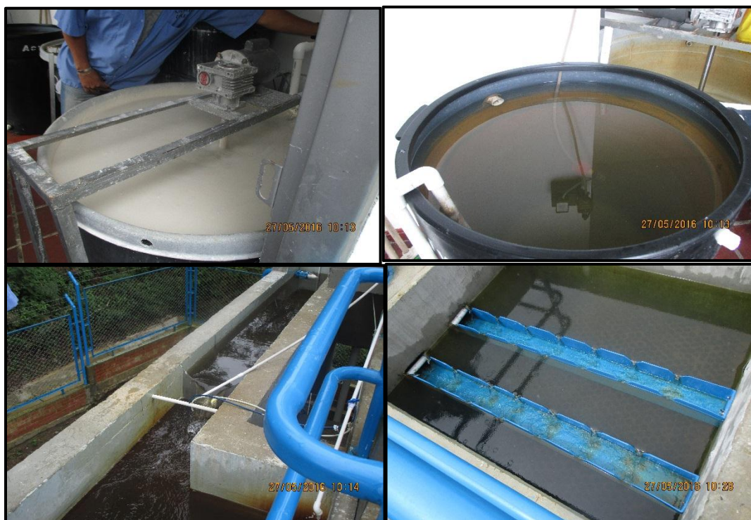
Imagen 12. Nueva Planta de tratamiento
