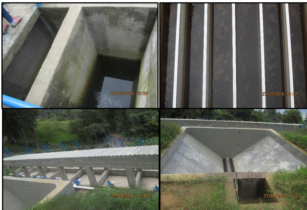
Imagen 13. Nueva Planta de tratamiento
