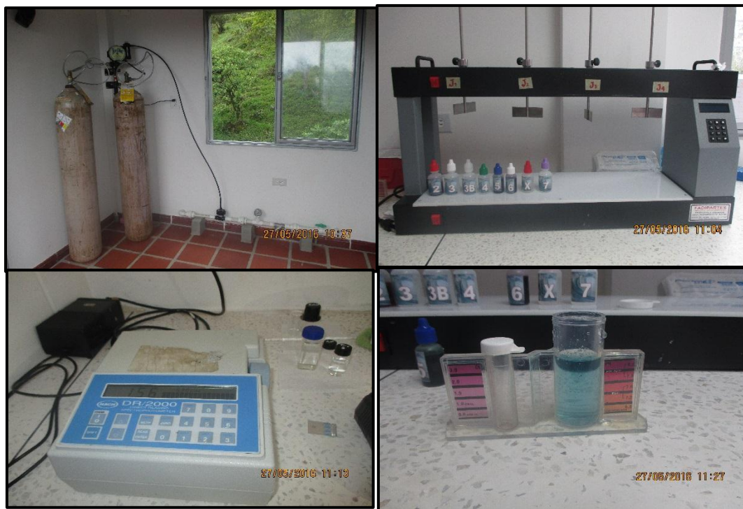
Imagen 14 Nueva planta de tratamiento (Laboratorio)
