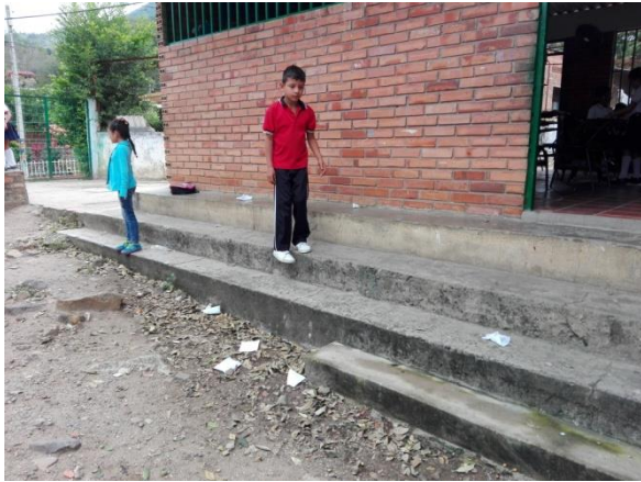
Patio de la sede con basuras.
