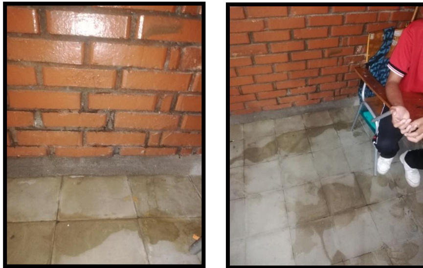
Foto No.10: Filtración de Aguas Lluvias (Primaria)
