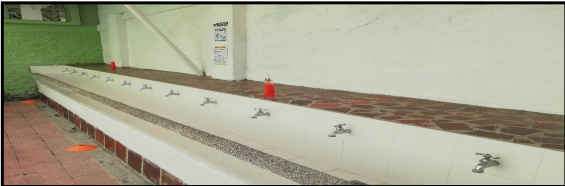
Foto No.1: ADECUACIONES FÍSICAS. Instalaciones de zonas de lavado de manos (Fijos y Portátiles) Secundaria.
