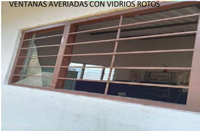
VENTANAS AVERIADAS CON VIDRIOS ROTOS
