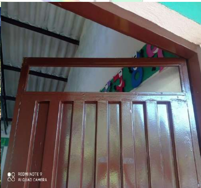
Puertas sin vidrio
