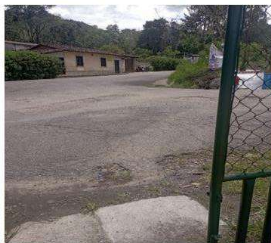
Carretera en un nivel mayor al del piso de la escuela, permitiendo que el agua lluvia ingrese a la escuela.
