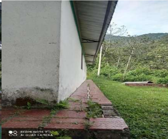
Hundimiento y deterioro del piso
