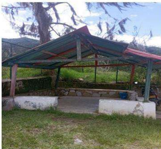
Kiosco en mal estado
