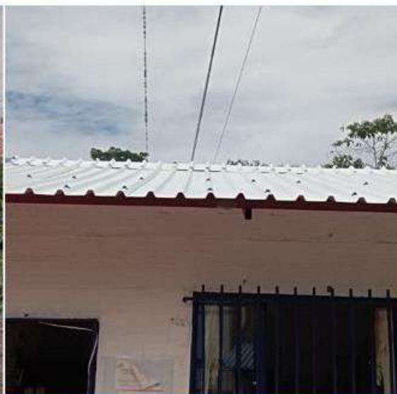
Cuerdas de alta tensión que pasan directamente sobre el tejado de la escuela.
