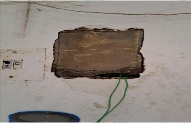
Entrada al contador en mal estado. eléctricas.
