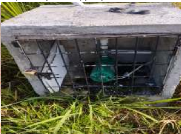
BÒVEDA TURBINA AGUA POTABLE
