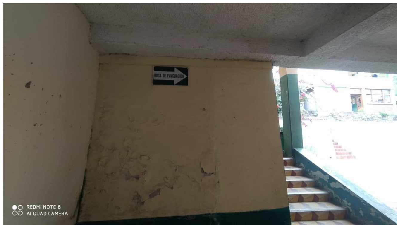
Anexo #4. Paredes húmedas, área de cooperativa. I.E. R.O.Y.
