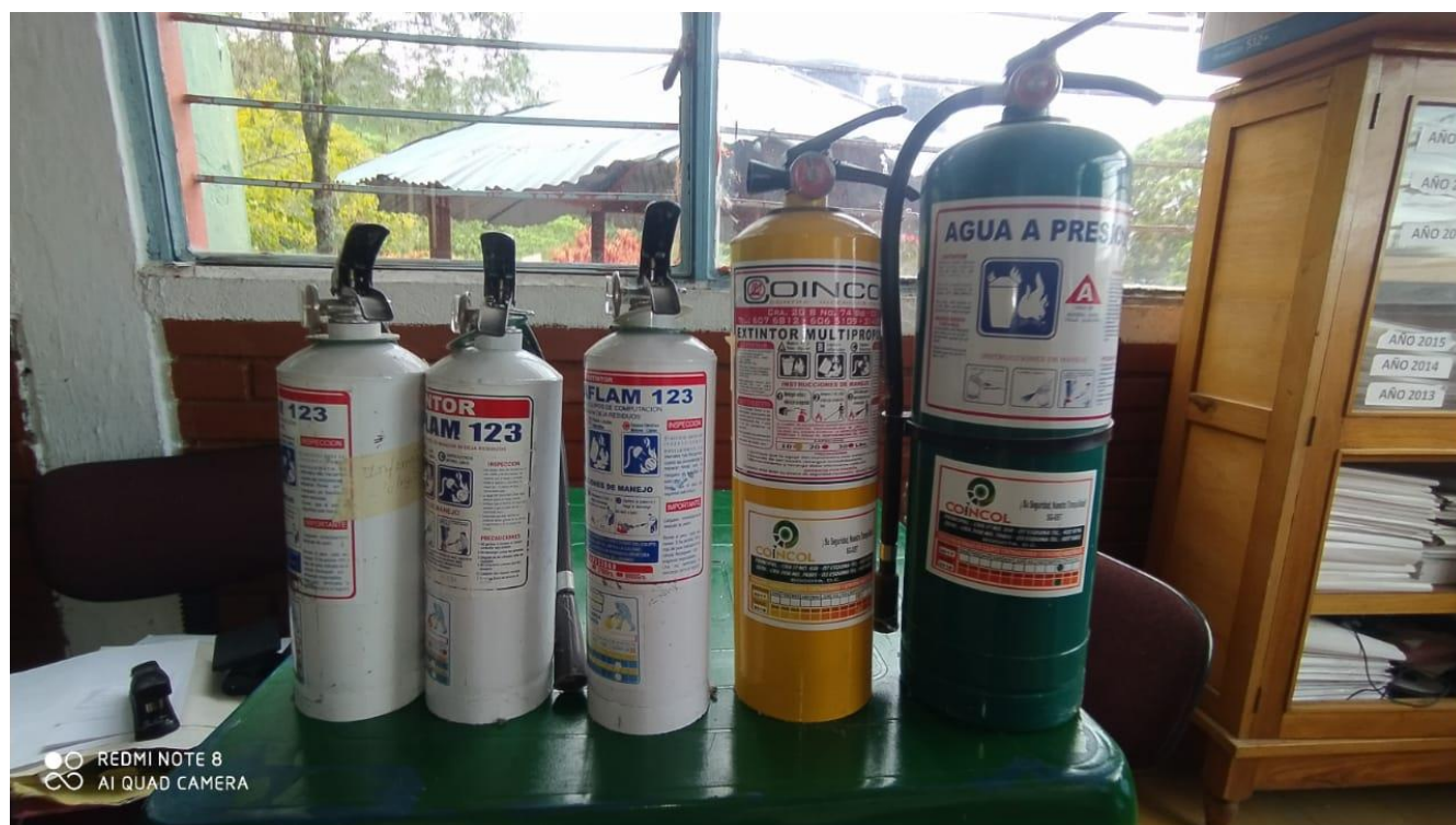
Anexo #3. Equipo de extintores de la Institución Educativa Raimundo Ordóñez Yáñez
