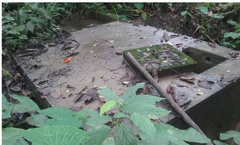
Acueducto del corregimiento
